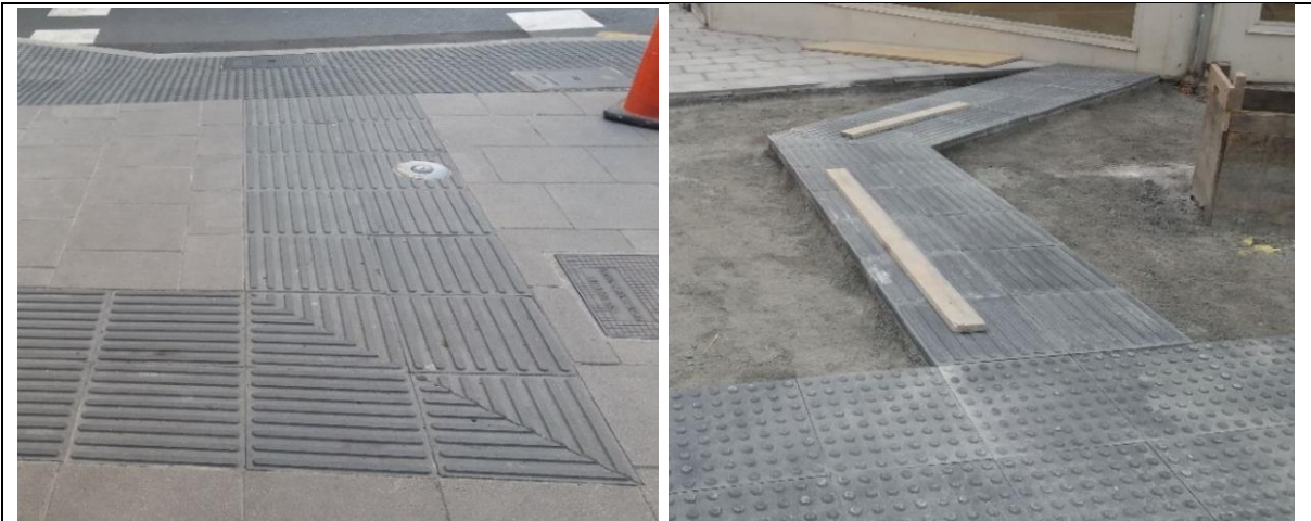
Exemplo de pezas en bisel de pavimento táctil indicador direccional en cambios de dirección dunha franxa guía
